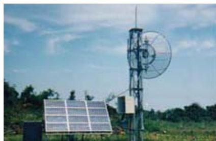
Εφαρμογή φωτοβολταϊκών στις τηλεπικοινωνίες
