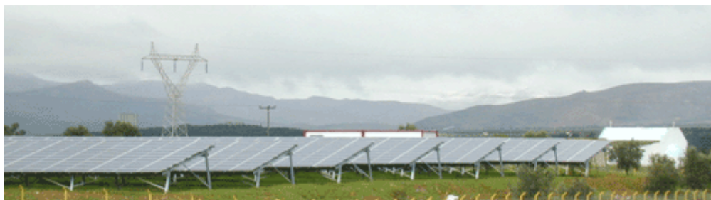
Ηλιακός σταθμός ηλεκτροπαραγωγής στην Κρήτη
