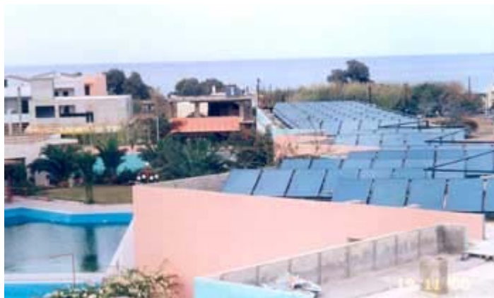
Εφαρμογή ηλιακού κλιματισμού σε ξενοδοχείο της Κρήτης
