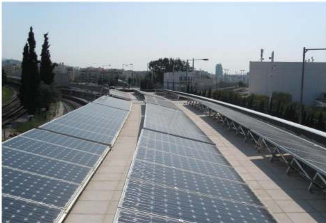
Φ/Β πλαίσια κρυσταλλικού πυριτίου, εγκατεστημένα σε στέγες του ΗΣΑΠ
