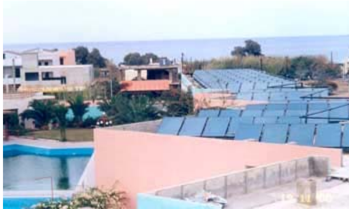
Εφαρμογή ηλιακού κλιματισμού σε ξενοδοχείο της Κρήτης
