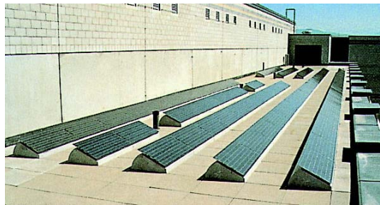
Εφαρμογή φωτοβολταϊκών σε ταράτσα κτιρίου
