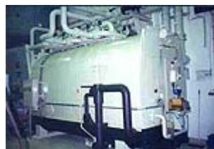
Από το σύστημα στα Οινόφυτα. Με ηλιακή ενέργεια, δύο ψύκτες συνολικής ισχύος 700kW παράγουν κρύο νερό 8–10 βαθμών. Το σύστημα ελέγχεται αυτόματα από υπολογιστή.
