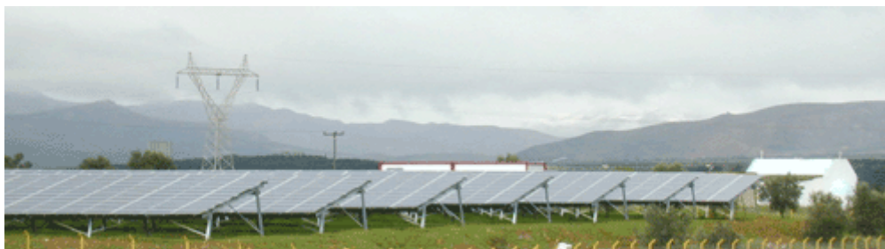
Ηλιακός σταθμός ηλεκτροπαραγωγής στην Κρήτη
