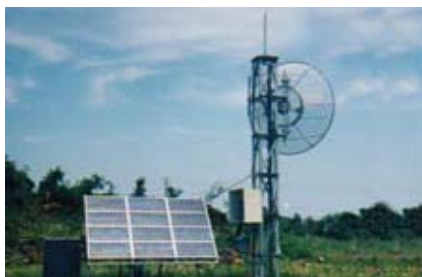
Εφαρμογή φωτοβολταϊκών στις τηλεπικοινωνίες
