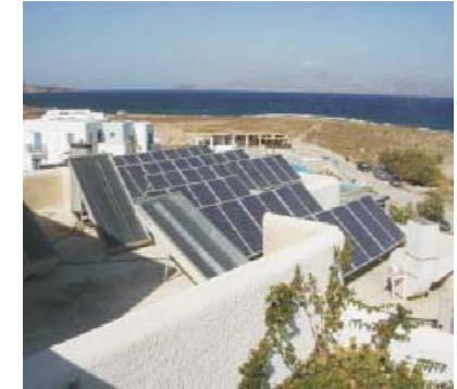
Εικόνα 8: Φωτοβολταϊκό σύστημα σε οροφή ξενοδοχείου – HOTRESS
