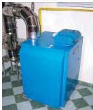
Εικόνα 11: Σύστημα συμπαραγωγής Αυστριακής κατασκευής
