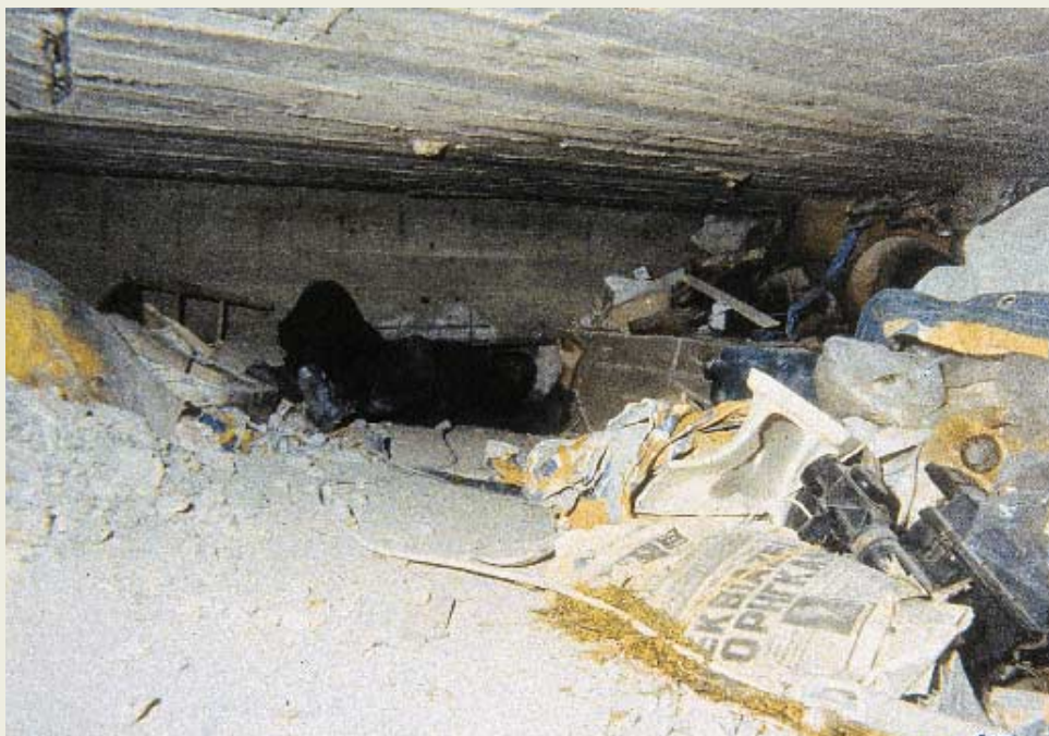
Φωτ. 13: Πιλοτή κτρίου που υπέστη ολική κατάρρευση. Παρά την έλλειψη τοίχων πληρώσεως υπάρχουν χώροι επαρκείς όχι μόνο για επιβίωση αλλά και για διεξαγωγή κατακόρυφης διείσδυσης ανόδου. (Άσκηση σε ερείπιο, Καλαμάτα 1986)
