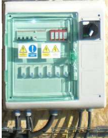
Εικόνα 22: Κουτί πλευράς δικτύου με τα εξαρτήματα προστασίας.
